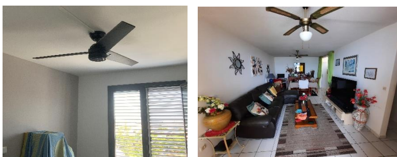
Figure 91 – Photos de brasseurs d'air dans les logements suivis
