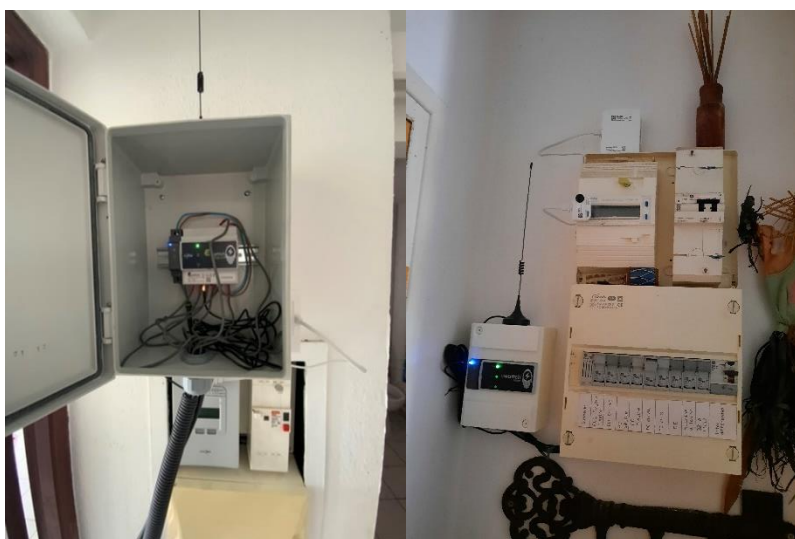
Figure 31 – Illustrations de l'instrumentation de tableau électrique parmi les logements instrumentés
