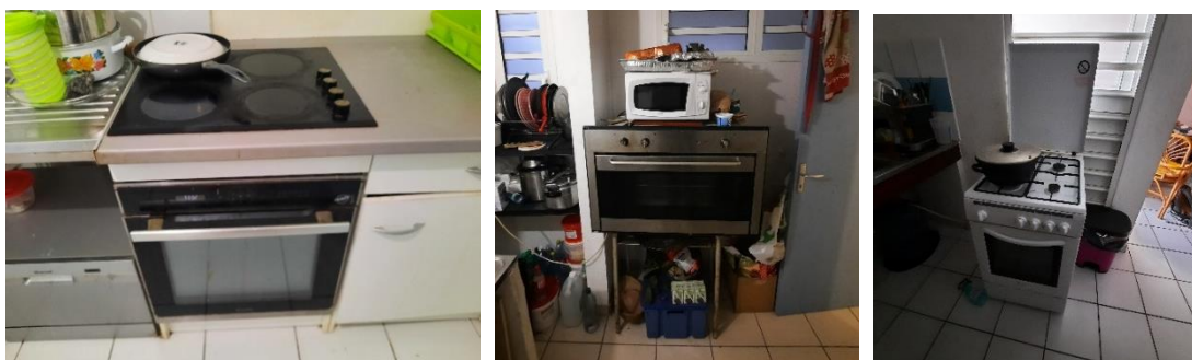
Figure 116 – Photos d'appareils de cuisson dans les logements instrumentés
